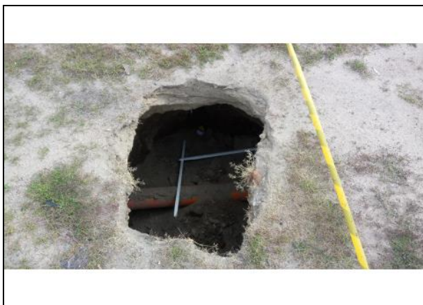
[56. Zapadlisko przed budynkiem Gimnazjum Miejskiego]
