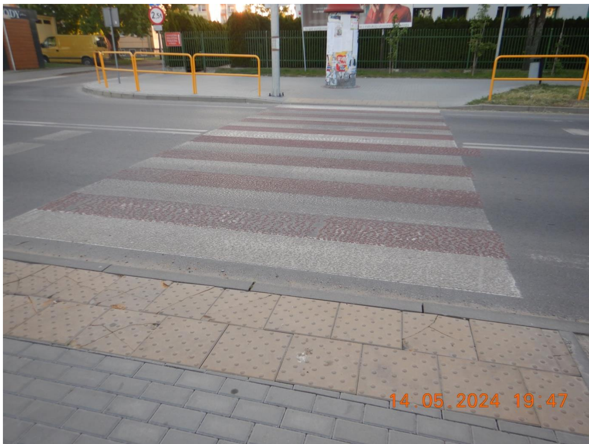
Przejście dla pieszych przy Liceum Ogólnokształcącym w Sierpcu – uszkodzone płyty chodnikowe.
