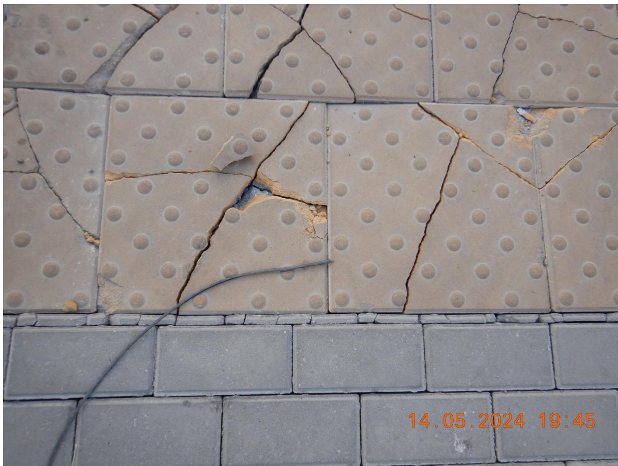
Przejście dla pieszych – uszkodzone płyty chodnikowe.
